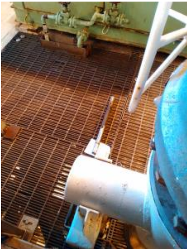
Plassering av ventilspindel på dørk etter utblåsin
